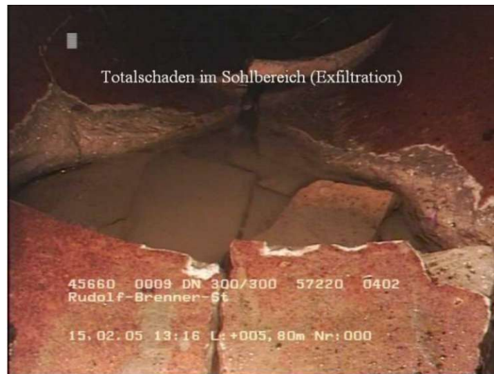
Abb. 5.2: Schadensbild Scherbildung Bodenbereich 98
