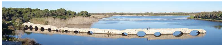
Abb. 3.15: Teilweise zerstörte Bogenbrücke auf Sardinien
