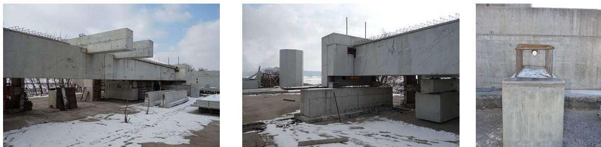
Abb. A.1: Bau Prototyp: Ausgangssituation Baufeld (links und mittig); Fundament K4 und Kernbohrung durch Widerlager 2 (rechts)
