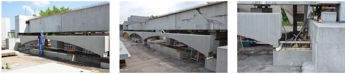
Abb. A.4: Bau Prototyp: Bogenträger 1 versetzt (links); Bogenträger 1 - 3 versetzt und Referenzblöcke teilweise hergestellt (mittig); Detail Verbindungsstück 2 vor der Betonage (rechts)
