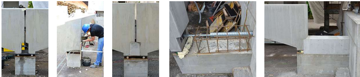
Abb. 4.10: Gekoppeltes Zugband vor der Betonage des Verbindungsstücks (links); Betonage Verbindungsstück (2.v.li.); Fertiggestellte Verbindung Bogenträger 1 und 2 (mittig); Kopplung Zugband und Bewehrungskorb Verbindungsstück Bogenträger 3 und Widerlager 2 (2.v.re.); Fertiggestelltes Verbindungsstück (rechts)
