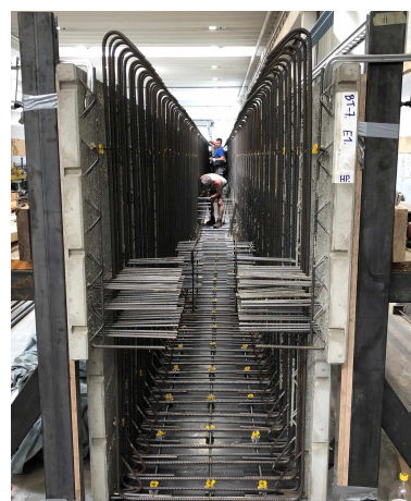
(b) Eingebaute Bewehrung vor der Betonage des Ankerblocks (Copyright: TU Wien, Kollegger)
